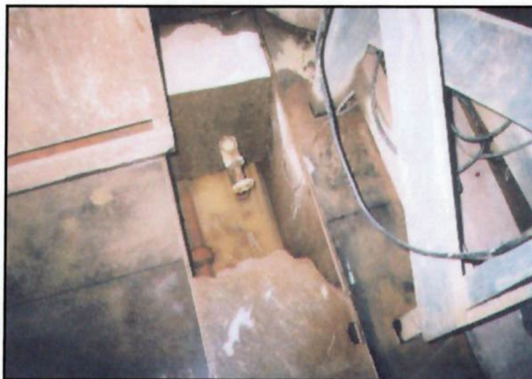
FOTO 8.6 – Piso deficiente no Laboratório de Tratamento de Minérios (LTM).
